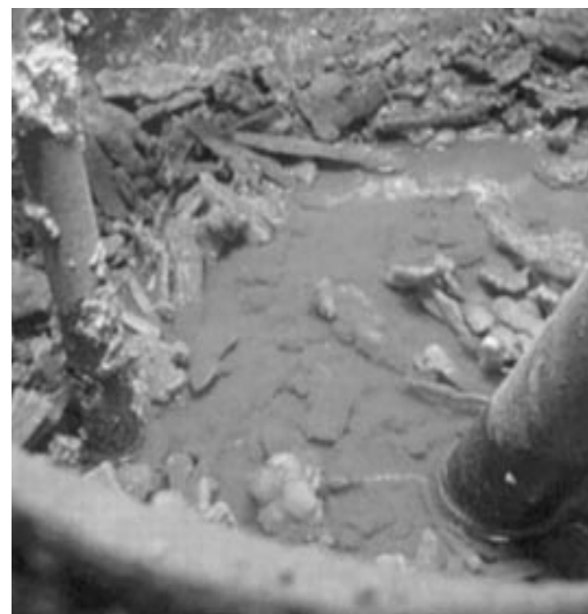
Rost, Verkrustungen, Sedimente in einem Warmwasser-Boiler. (Foto: Axima)
