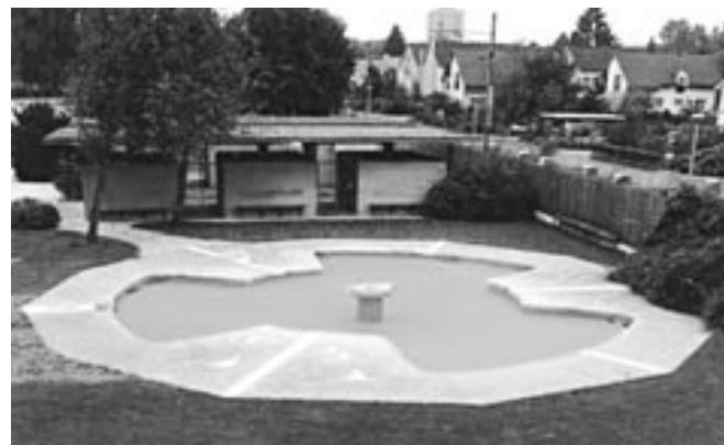
Planschbecken, Baujahr 1959. Blosser Wasserflächen, ohne jegliche Attraktionen. Nichts, das die Kinder begeistern und sie und ihre Eltern als Badegäste anziehen würde. Keine Sitzgelegenheiten, keine normenkonforme Wasseraufbereitung. Heute noch in Betrieb.
