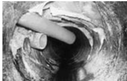
Walterhaltung – Die modernen Überwachungssysteme bringen es an den Tag: Falsche Einführung von Nebenanschlüssen in einer Kanalisation.
