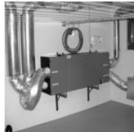
Der Wärmetauscher ermöglicht die Rückgewinnung von drei Vierteln der Wärme. (Fotos: zvg)
