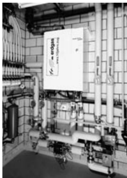
Beheizen ein ganzes Gewerbe- und Wohnhaus in Vevey aus einer Dachheizzentrale: Zwei modulierende 40-kW-Gas-Kondensations-Wandkessel.
