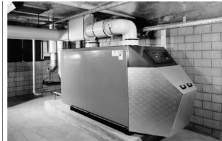
Moduliert von 35–400 kW: Gas-Kondensationskessel im Dachstock der neuen Curlinghalle in Bern (links im Bild). (Fotos: Peter Morf, Zürich/VSG)
