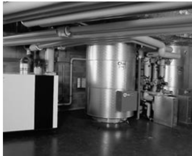
Früher hätte man zwei Kessel montiert, heute genügt ein modulierender Gas-Kondensationskessel mit 613 kW Leistung (links im Bild) für das neue Velodrom in Aigle.
