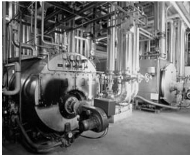
Typischer Einsatz für Gas/Öl-Zweistoffbrenner: Links an einem 1,1 l-Tonnen-Dampfkessel, hinten an einem der beiden 3,4-MW-Heisswasserkessel der Swiss Dairy Food in Mont-sur-Lausanne. (Foto: Christian Poite, Genève/VSG)
