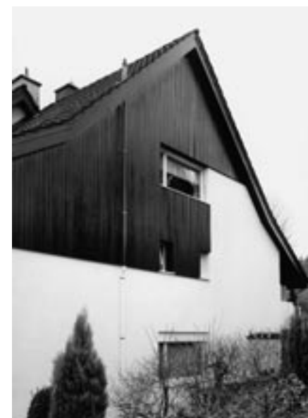
Diskret in der Farbe der Fassade bemalt, fällt die Aussen-Abgasleitung kaum auf.
