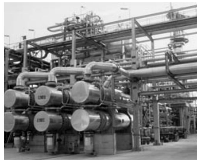
Qualitätsbrennstoffe produzieren die beiden einzigen Schweizer Inlandraffinerien – hier eine Teilansicht der Raffinerie Cressier.
