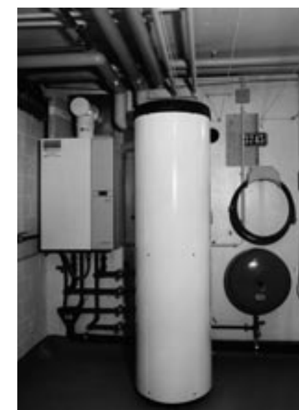
Der neue Gas-Kondensations-Wandkessel (links im Bild) verwendet die bestehende Aussparung für Luftansaug und Abgasleitung. Rechts der 140-Liter-Speicher.
