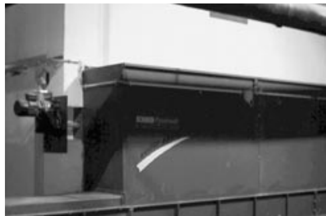
Teilansicht der Holzfeuerungsanlage im Betrieb von Josef Sidler, Holzbau, Nottwil.
