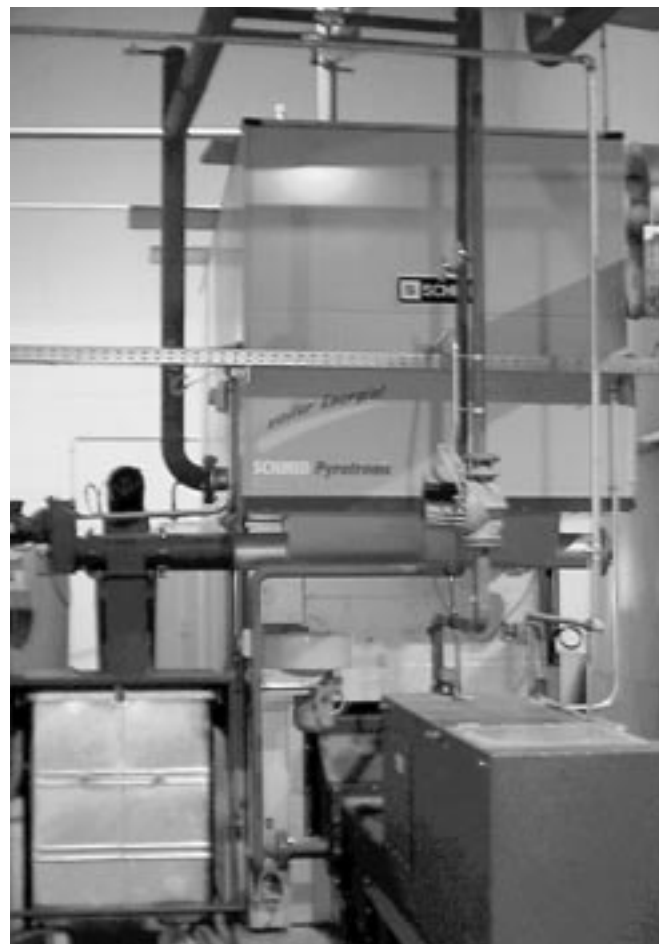
Blick auf die moderne 900-kW-Vorschubrostfeuerungsanlage «Schmid Pyrotronic».
