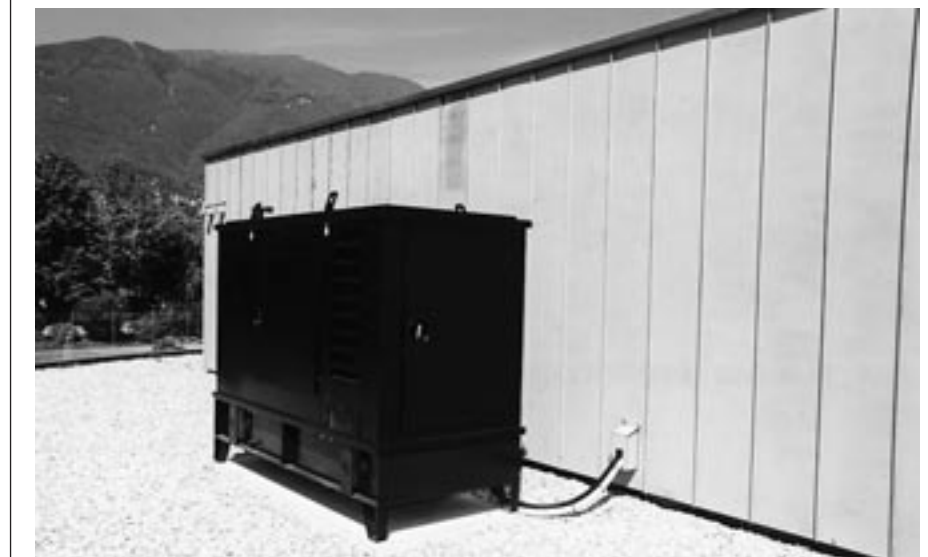
Notstromaggregat auf dem Dach.
