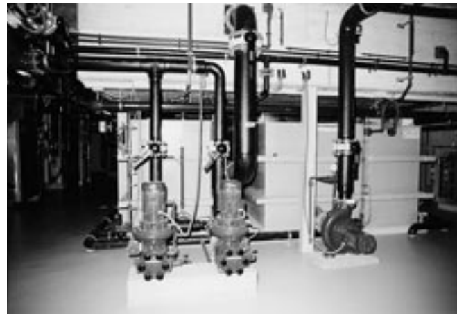
Umwälzpumpen mit Spülwasserpumpe.
