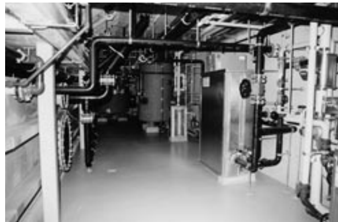
Neuer Technikraum mit Kunststoffbehälter als Schwallwasserbecken.
