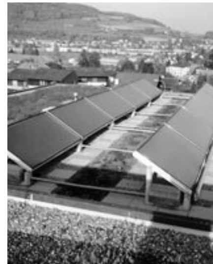
Bis zu 60% der benötigten Energie für warmes Wasser lassen sich mit einer Solaranlage decken.
