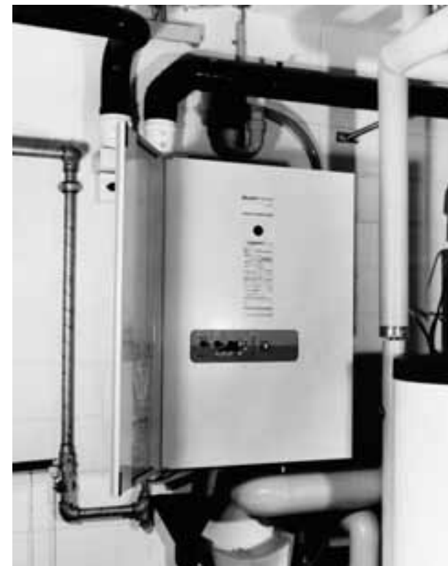
Moduliert seit 6. September 1999 von 0,9–9 kW, vorher von 5–15 kW: der Kondensations-Gas-Wandkessel im Keller des Hauses von Beat Kuhn in Märstetten.
