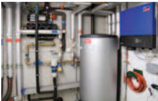
Der Haustechnikraum ist bedürfnisorientiert geplant.
