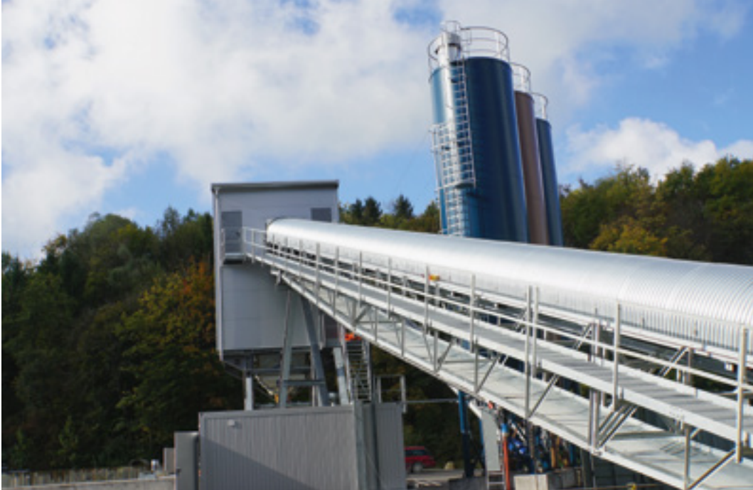
Blick auf die neue ökologische Betonanlage im Kieswerk Eschenbach LU.
