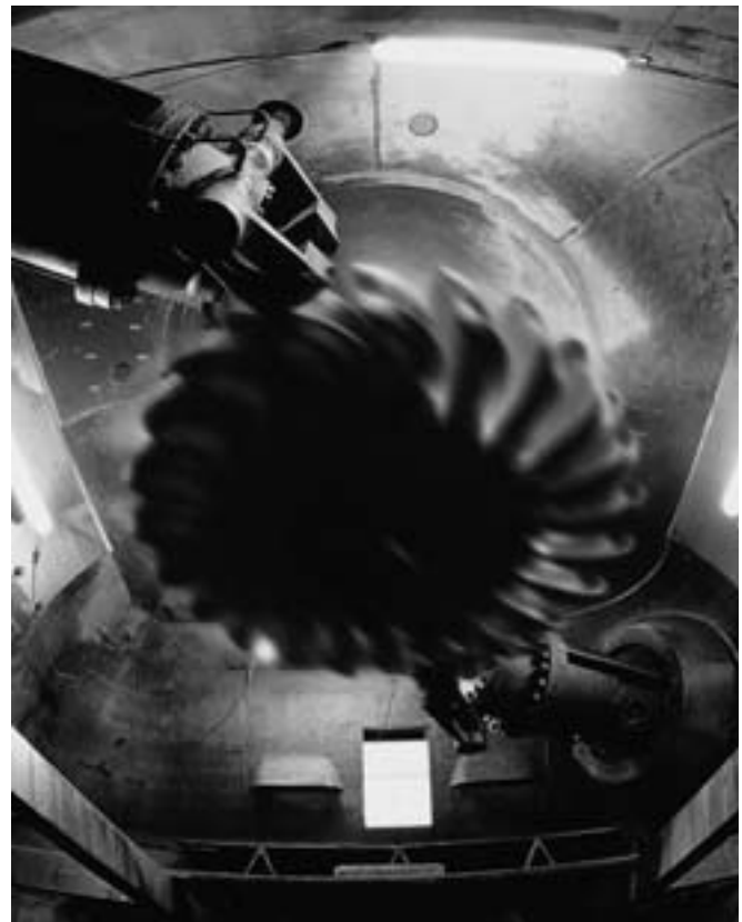
Peltonrad im Kraftwerk Innertkirchen 1.
