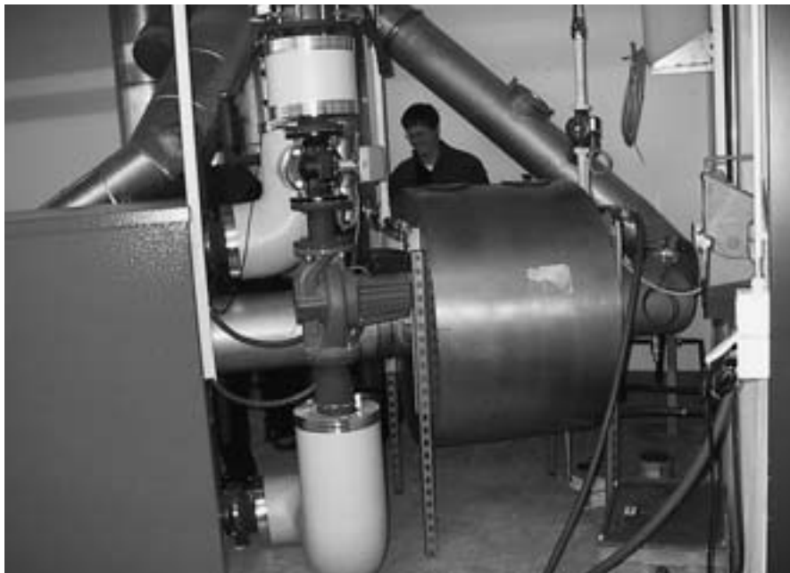
Die Brennwertnutzung ist auch für grössere Leistungen in Gewerbe- und Industrieanlagen möglich. Bild: Kesselanlage mit angebautem Wärmetauscher für ein Hotel.
