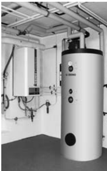
Der Brennwertkessel (links oben) an der Wand: hohe Energieeffizienz auf kleinstem Raum.
