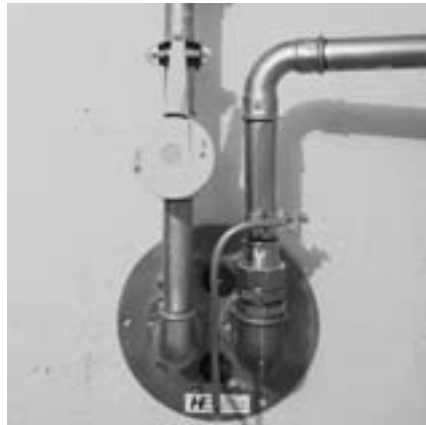
Die Mehrsparten-Hauseinführung für Gas und Wasser; in der Mitte die Erdung für Potentialausgleich.
