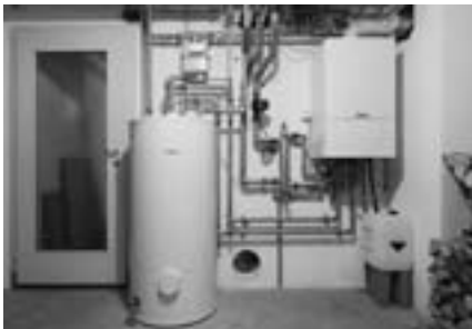
Neu genügt ein Gas-Kondensationskessel (11,4 – 27 kW) mit 200-Liter-Boiler. Die Leitungen sind noch nicht isoliert, der Anschluss der Abgasleitung oben rechts erfolgte nach Inbetriebnahme, ebenso ein richtiger Kondensatablauf – die Lösung mit dem Tank ist provisorisch.
