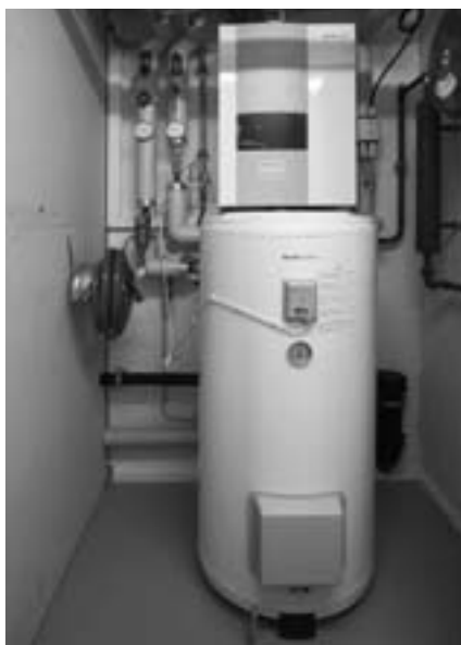
Für jede Wohnung ein modulierender Gas-Kondensations-Wandkessel und ein Beistellboiler in einem Schrank im Keller.
