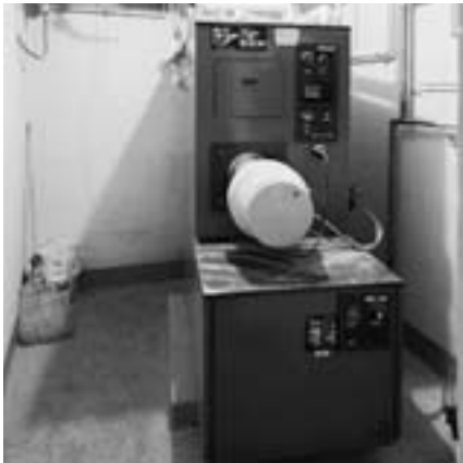
...trotzdem waren die 48 kW Heizleistung des alten Kessels etwas reichlich dimensioniert.
