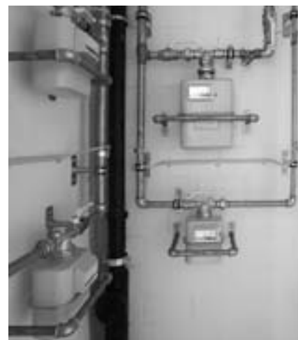
Verbrauchsabrechnung über Gaszähler für jede Wohnung in einem separaten Kellerschrank.
