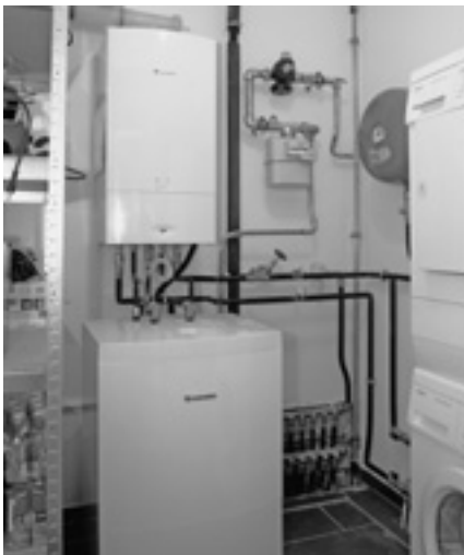
Gas-Kondensationskessel und Beistellboiler im Technikraum einer Wohnung.
