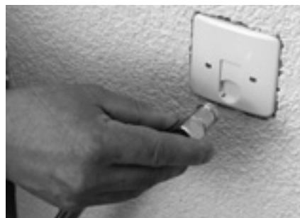
Diese Gas-Steckdose auf dem Balkon erlaubt den Anschluss eines Erdgas-Grills.
