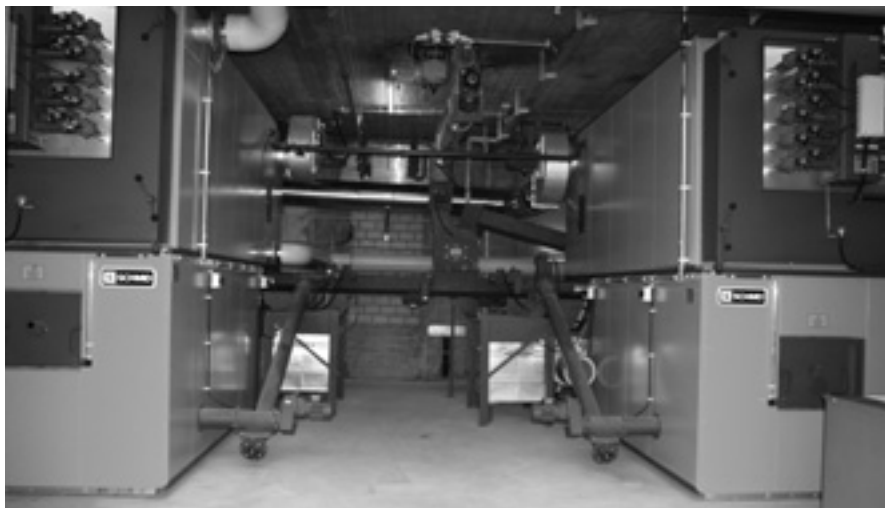
Blick auf die Holzverbrennungsanlage (installiert sind zwei «Schmid»-Heizkessel mit einer Gesamtleistung von 2,8 Megawatt) im Betrieb der WK-Paletten AG in Schüpbach BE.
