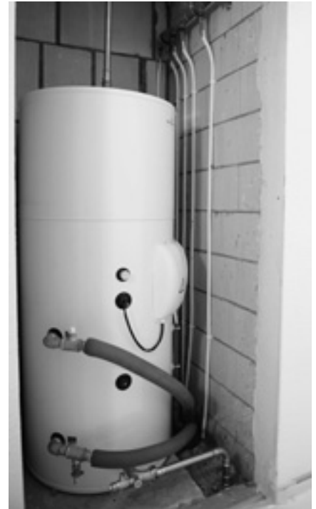
Der neue Wassererwärmer liefert Warmwasser für alle Zapfstellen im Haus.
