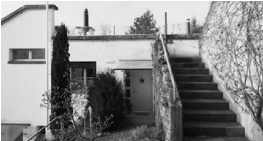
Die Abgasleitungen stören optisch nicht. Die Erdgas-Zuleitungen für die Reihenhäuser am Hang wurden am Hummelberg in Jona SG diskret aussen verlegt (unter dem Mauersims).
