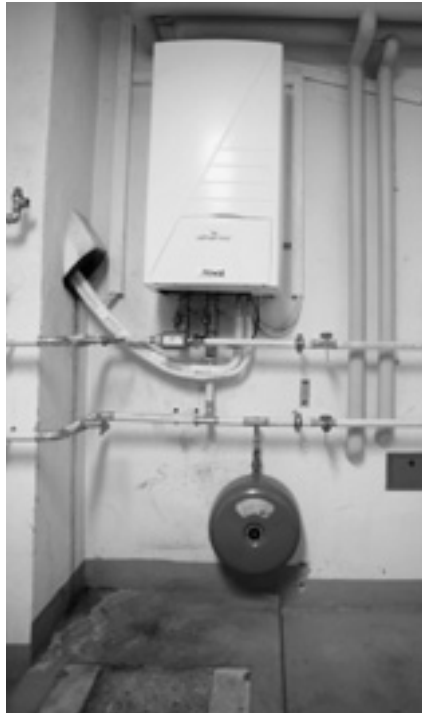
Das wandmontierte Altherma-Innengerät schafft viel freien Raum im alten Heizraum.
