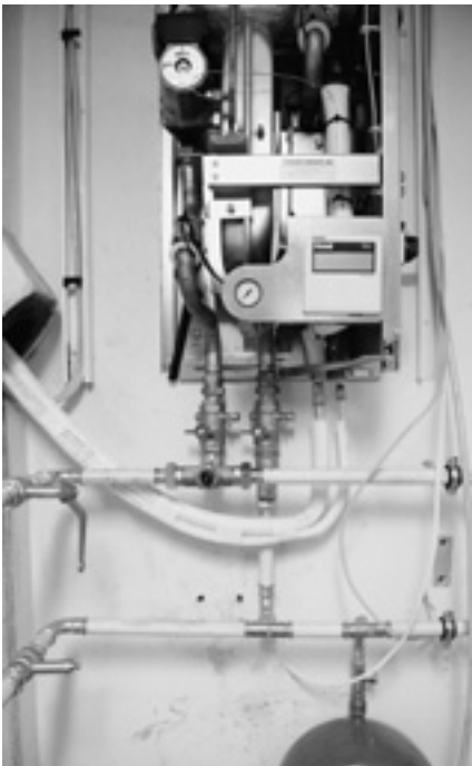
Im Hoval Altherma-Innengerät wird die Energie an das Heizsystem und an den Warmwasserboiler übertragen.
