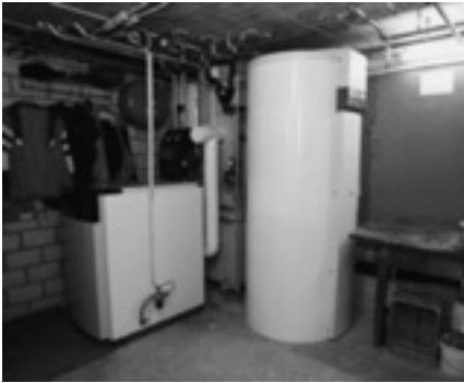
Blick in den Heizungskeller mit dem neuen Öl-Brennwertkessel, aufgebauter Mischgruppe, LAS-Abgassystem, Solarboiler, Regler und Solarpumpengruppe in Kaskade.
