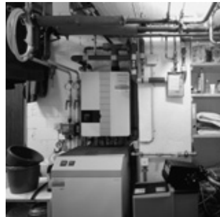
Gas-Kondensationskessel und Beistell-Boiler brauchen wenig Platz. So konnte sich der Besitzer dieses Einfamilienhauses in Pratteln BL durch den gewonnenen Raum eine Wellness-Zone einrichten.
