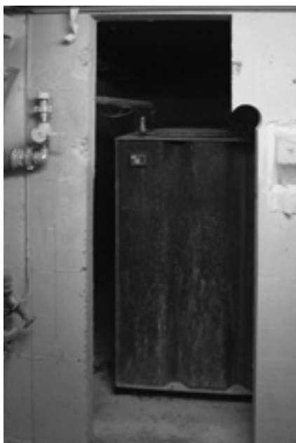
Der alte Öltank vor der Entfernung.
