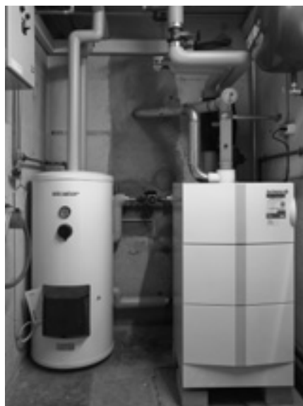
Gas-Kondensationskessel, modulierend von 5 bis 30 kW, und Beistellboiler in der neuen Heizzentrale.
