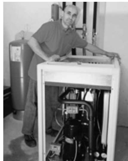
Für Werner Burri, Gruppenleiter, Elco Geschäftsstelle Winterthur, ist die Wärmeerzeugung mit Solar- und Umweltenergie eine besonders nachhaltige und effiziente Lösung.
