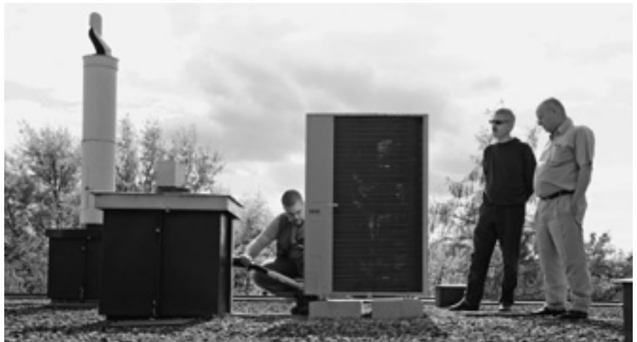
Eigentümer Lehner und Unternehmer Ganz sind mit der neuen Hoval-Heizung zufrieden.
