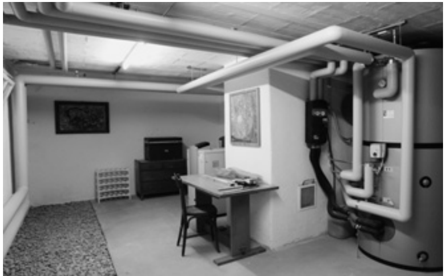
Blick in den neuen Heizungskeller mit Kombispeicher und Wärmepumpe (hinten).
