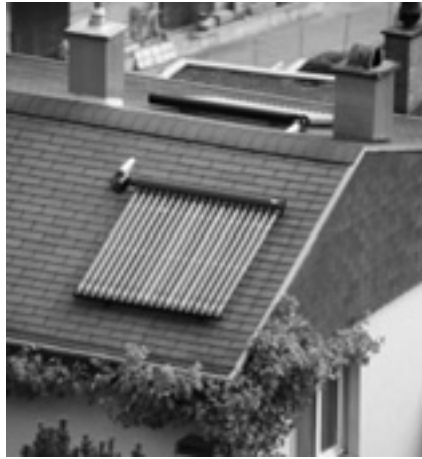
Um einen noch besseren Solarertrag zu erhalten, wurde je ein Vakuumröhrenkollektor mit 2 Quadratmetern Absorberfläche auf beiden Dachhälften installiert.
