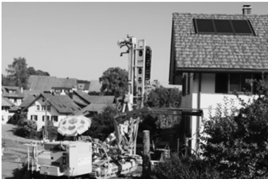
Die Erdsondenbohrung erfolgte auf eine Tiefe von 150 m. Die Solaranlage auf dem Dach des Hauses der Familie Heller dient zur Warmwasserbereitung und Heizungsunterstützung.
